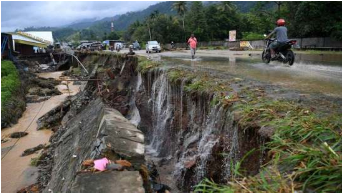
Warga melintas di samping jalan yang rusak akibat banjir bandang di Sentani, Kabupaten Jaya Pura, Papua.
